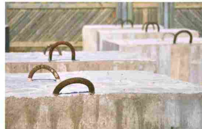
Egengjutna ankare. 10 stycken betongankare ska hålla flotten och bryggan på plats. Totalt har 24 ton betong gått åt till gjutningen.
